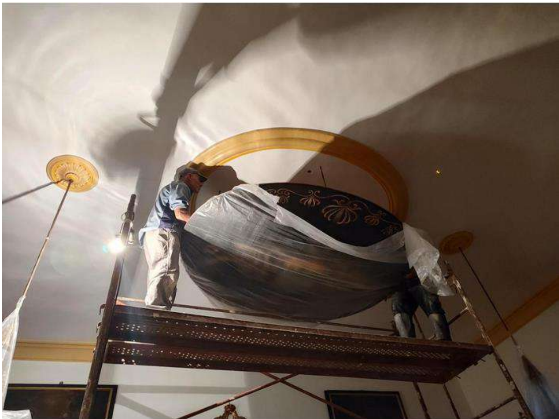
Image de la remise en place de la toile, une fois la restauration finalisée.
